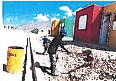
Morne-à-Cabrit: 750 logements de 40 m 2 sont en cours de construction. PHOTO: H. CHERRY DROMARQ
